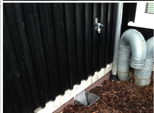
Øverst: Campus Ullandhaug, studentboliger i Stavanger | Foto: Multiconsult Nederst: Tiltak utført i Novvegen, Sola kommune i form av utlufting i ringmur under betongdekket | Ill.: Multiconsult
