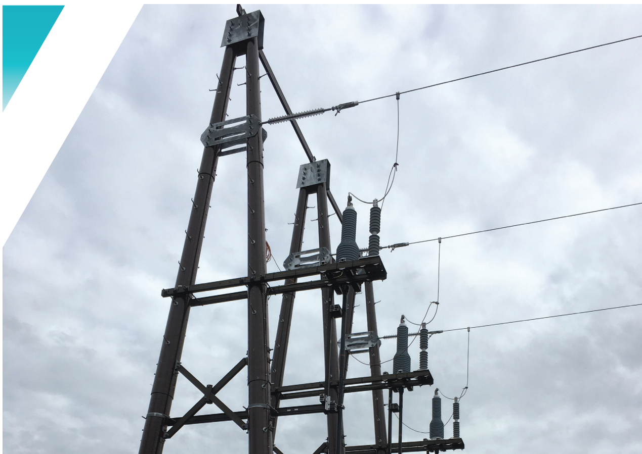
Kabelmast 3A | Foto: Stein Øksnes, Multiconsult
