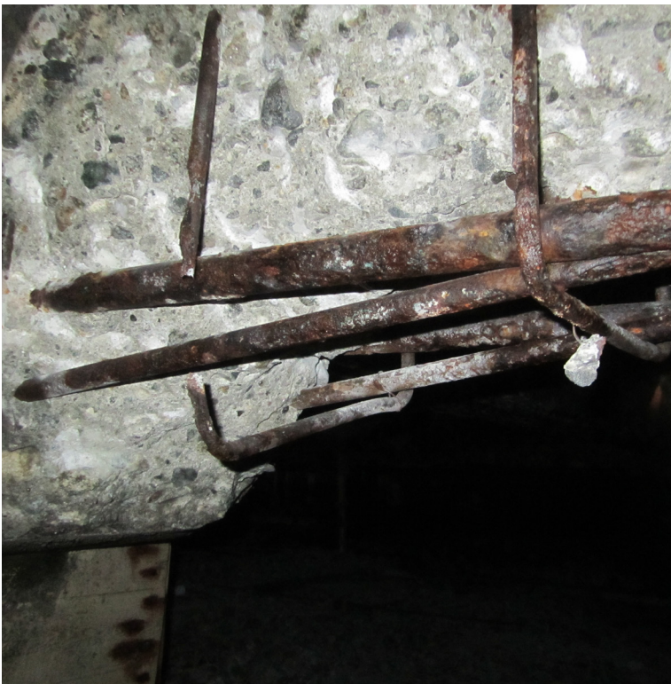
Armeringskorrosjon dragere | Foto: Jon Vetlesen, Multiconsult
