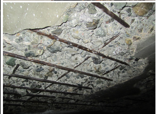
Øverst: Skap for strømforsyning til katodisk anlegg | Foto: Jon Vetlesen, Multiconsult Nederst: Armeringskorrosjon i underkant av kaidekke | Foto: Jon Vetlesen, Multiconsult
